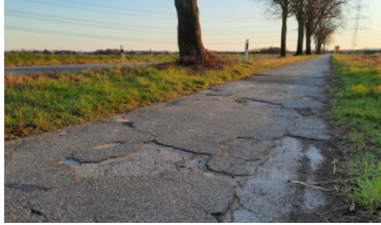
Schlechter Zustand des Geh- und Radwegs zwischen Sinnersdorf und Pulheim
